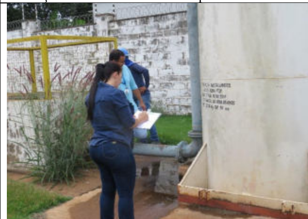
Autor: AMAE Descrição: REL Saint Martin – Identificação de vazamento e validade da estrutura metálica do reservatório.
