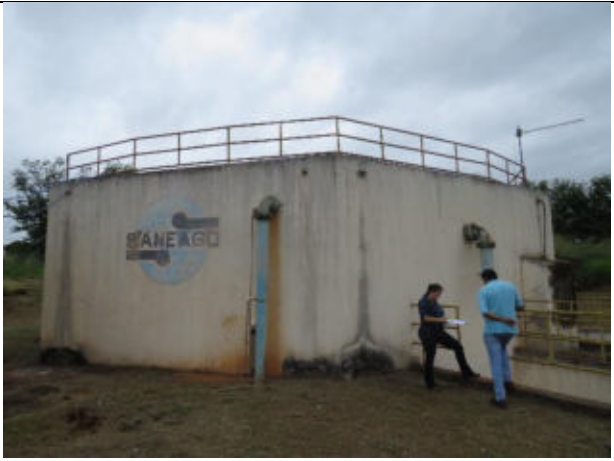
Autor: AMAE Descrição: RST Fesurv – Corrosão na base.
