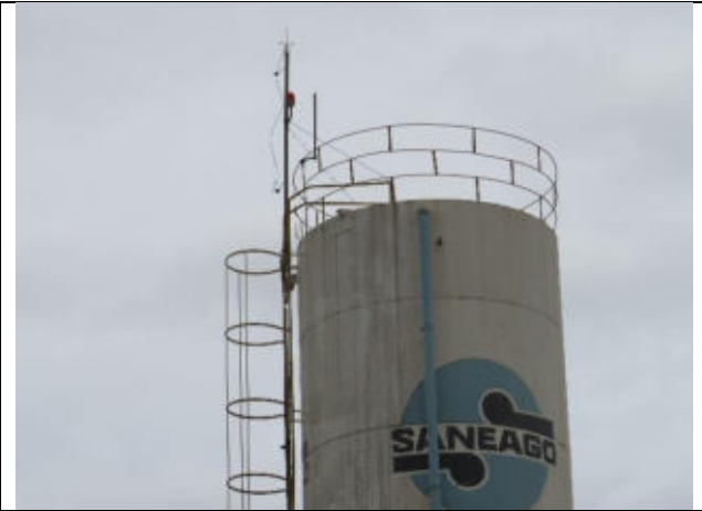
Autor: AMAE Descrição: REL Fesurv – escada tipo marinheiro e guarda-corpo no teto, sem cabos de aterramento para raios e sinalização noturna.
