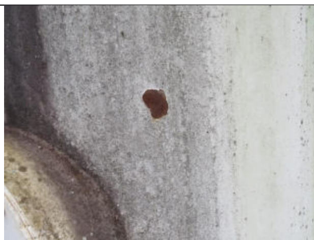
Autor: AMAE Descrição: Corrosão sob tensão.
