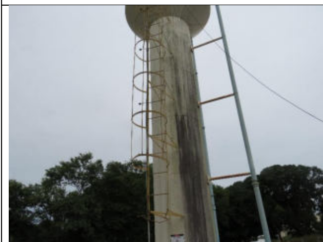
Autor: AMAE Descrição: REL Fesurv – escada tipo marinheiro, sem cabos de aterramento para-raios e sinalização noturna. Manchas na parede externa do reservatório.
