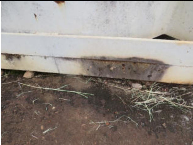
Autor: AMAE Descrição: REL Fesurv – Corrosão sob tensão na base.
