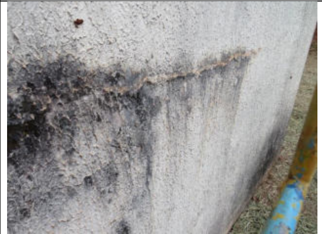
Autor: AMAE Descrição: RST Fesurv – Trincas na parede.
