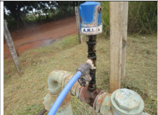
Autor: AMAE Descrição: Vazamento na ventosa do poço.
