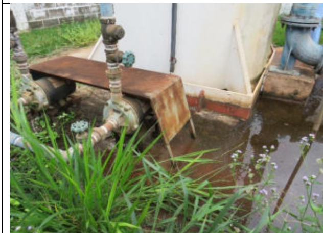
Autor: AMAE Descrição: Vazamento Saint Martin.
